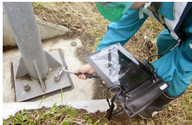
写真2 ナットのゆるみ測定状況
